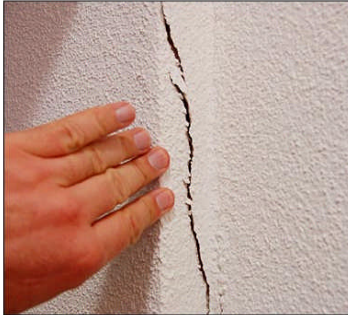
Die Risse im Rathausgemäuer sind deutlich zu erkennen.
