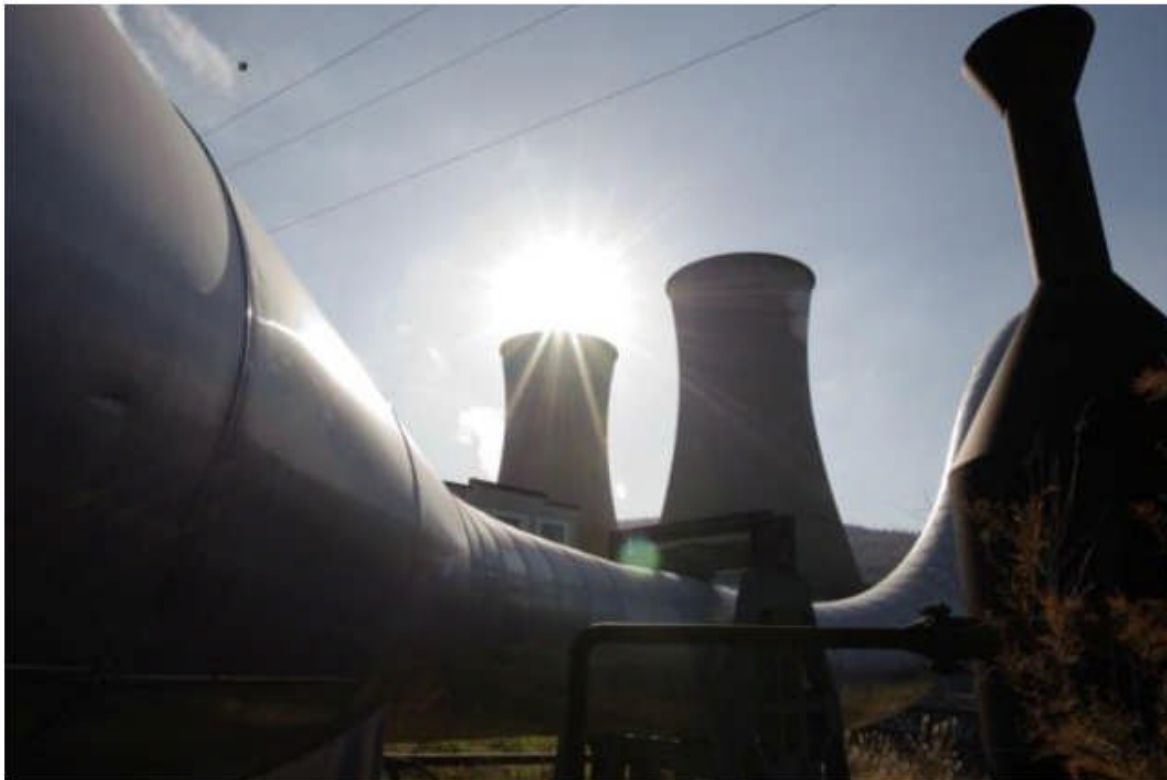
Ähnliche Anlagen könnten bald in der Schweiz stehen: Eine Pipeline zum Transport von Dampf beim Geothermiekraftwerk in Larderello in der italienischen Region Toscana. (25. November 2009) Bild: AFP
