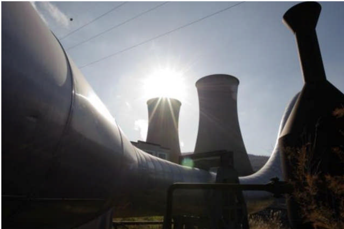
Ähnliche Anlagen könnten bald in der Schweiz stehen: Eine Pipeline zum Transport von Dampf beim Geothermiekraftwerk in Larderello in der italienischen Region Toscana. (25. November 2009) Bild: AFP
