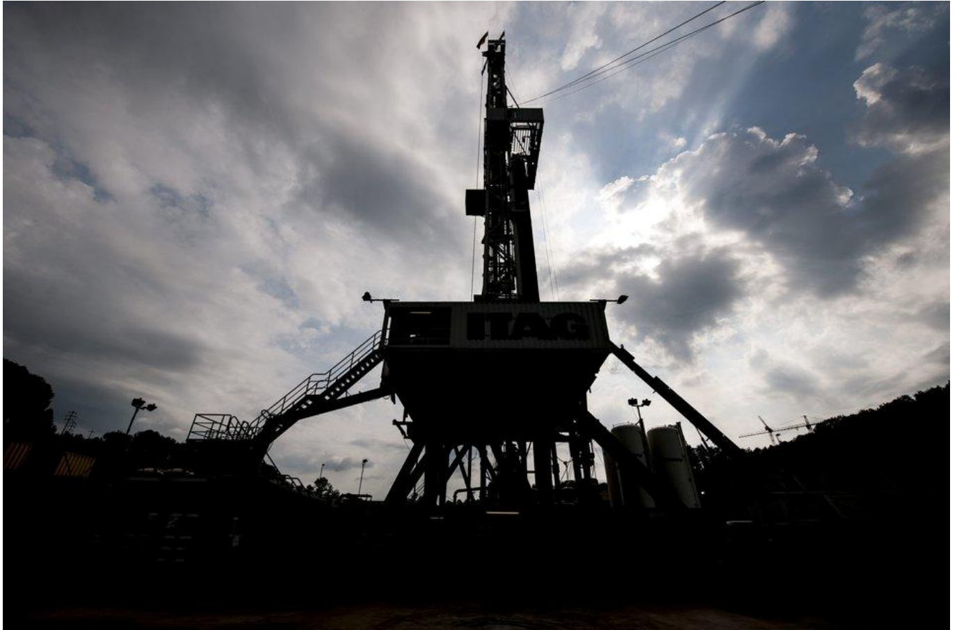
Foto: Das Projekt wurde nach dem Erdbeben unterbrochen: Geothermieranlage im Sittertobel in St. Gallen. (24. Juli 2013) Bild: Ennio Leanza/Keystone
