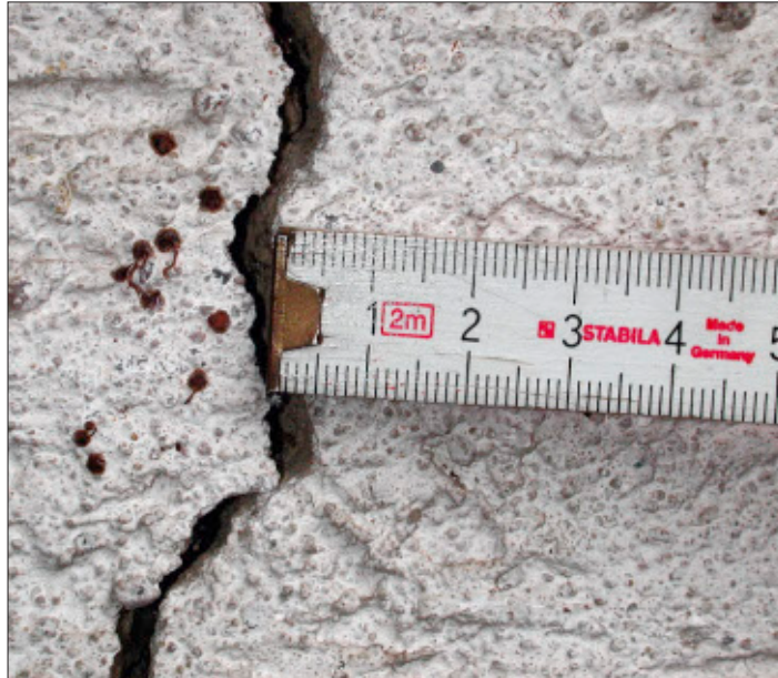
Risse in der Wand und kaputte Gegenstände wie Lampen sind die häufigsten der 1 500 Erdbeben-Schadensmeldungen. FOTO: MZD
